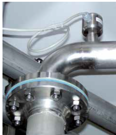
Monitoramento de vazão/proteção contra funcionamento a seco
