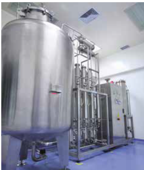
Medição de vazão de água desmineralizada
